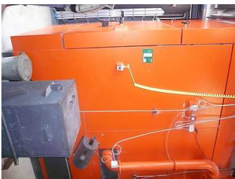
Holzschnitzelheizung (Zentralheizung / Wärmeverbund)
